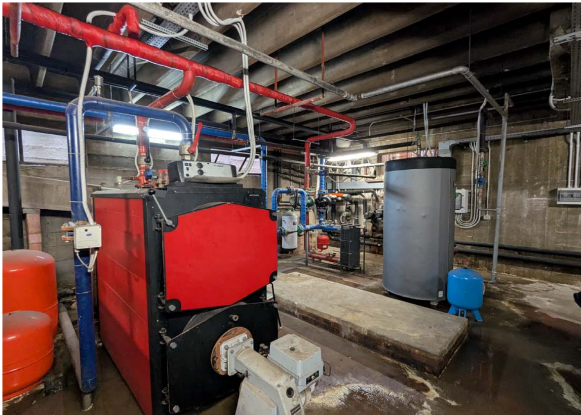
Figura 1 - Zona di installazione del nuovo micro-cogeneratore
