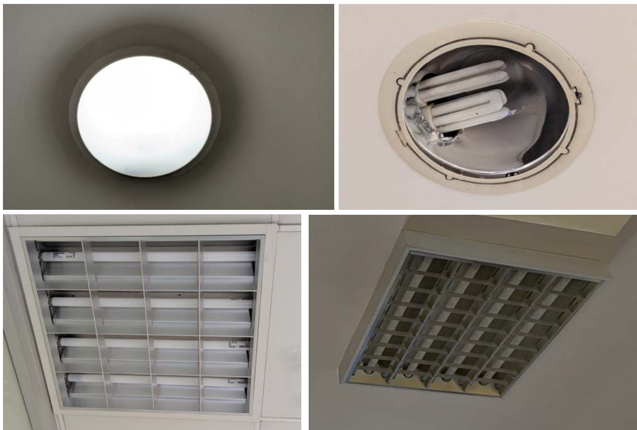
Figura 1 – esempi di corpi illuminanti fluorescenti attualmente installati
