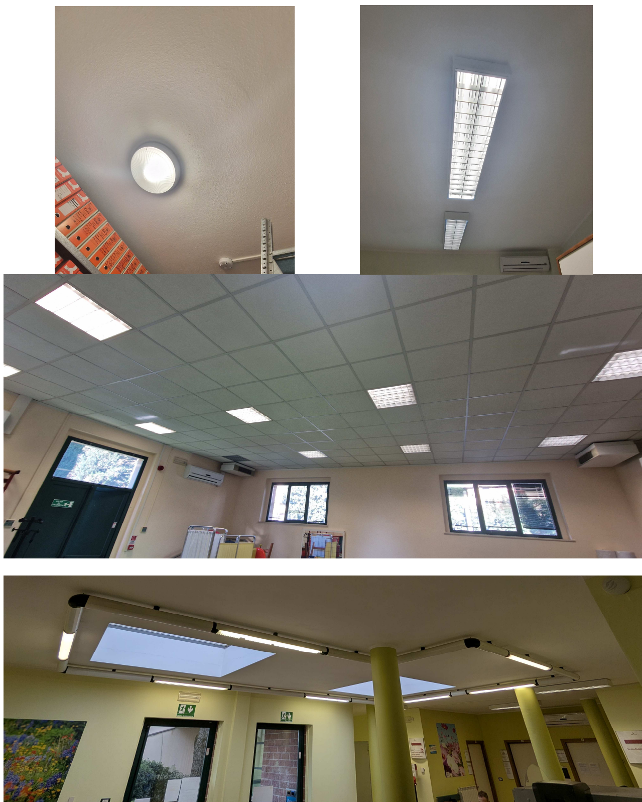
Figura 2 – esempi di corpi illuminanti fluorescenti attualmente installati
