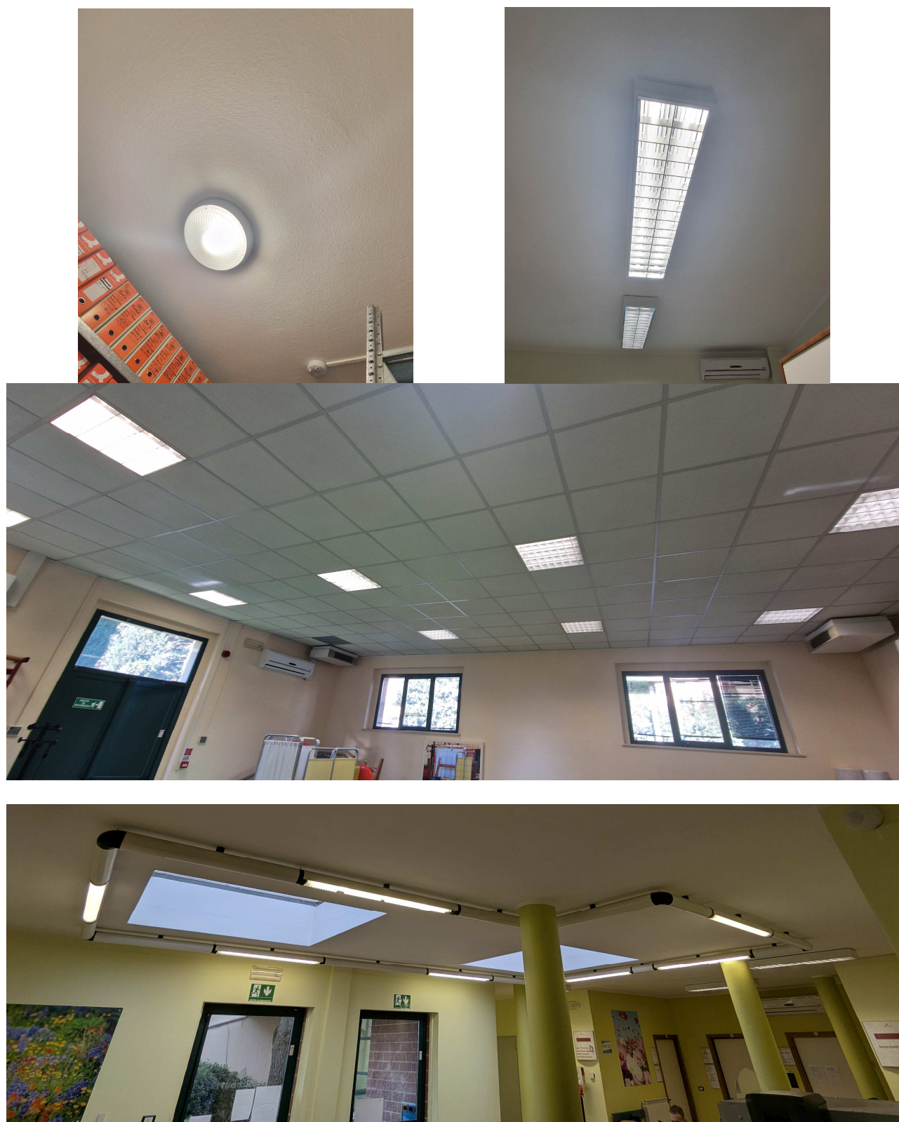
Figura 2 – esempi di corpi illuminanti fluorescenti attualmente installati
