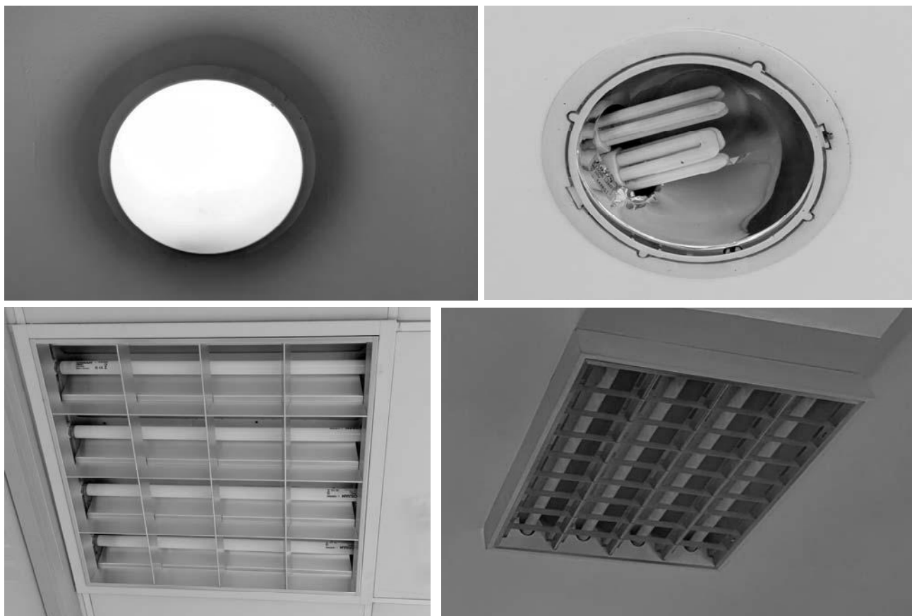
Figura 1 – esempi di corpi illuminanti fluorescenti attualmente installati
